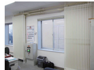
輻射式室内機・操作盤
