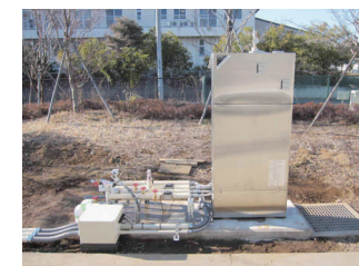
ヒートポンプユニット
